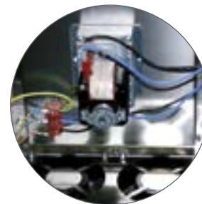
Ventilation des moteurs / Motors ventilation
